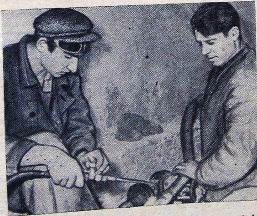
Год тому назад демобилизовался из рядов Советской Армии Геннадий Лобазов. Он пришел работать на стройку и здесь овладел специальностью сварщика. Сейчас Геннадий — хороший производственный. Вместе с ним трудится слесарь Николай Хижняк. На снимке: сварщик Г. Лобазов и Н. Хижняк за работой. Фото Н. Печенова.
