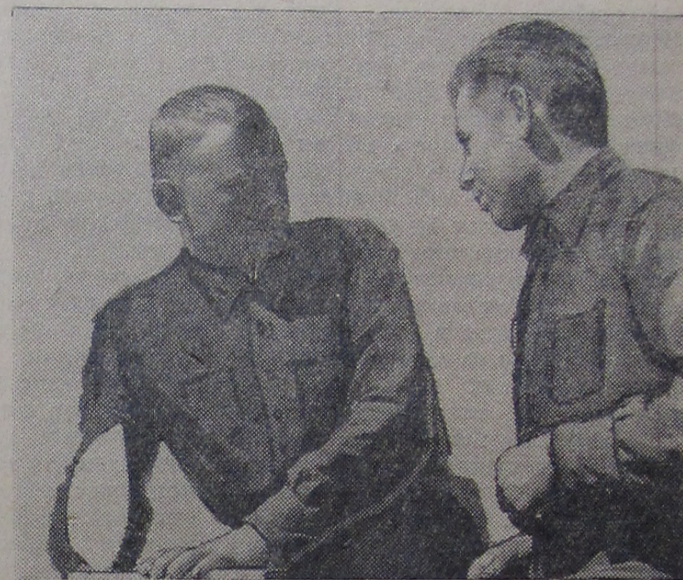
Звено каменщиков Александра Сапачука ведет кладку стен детского сада № 3 в третьем строительном квартале. Сегодня они заканчивают кладку стен второго этажа.
