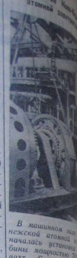
В машинном зале нежской атомной электростанции началась установка турбины мощностью 70 тысяч ватт. Соревнуясь в конкурсе на строительство атомной электростанции, записались досрочно собрать агрегаты.
