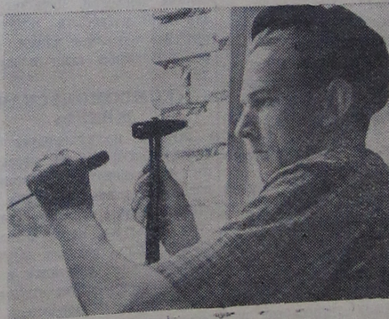
На строительстве одиннадцатилетней школы хорошо работает опытный столяр В. И. Коптелов. Фото Н. Печенова.
