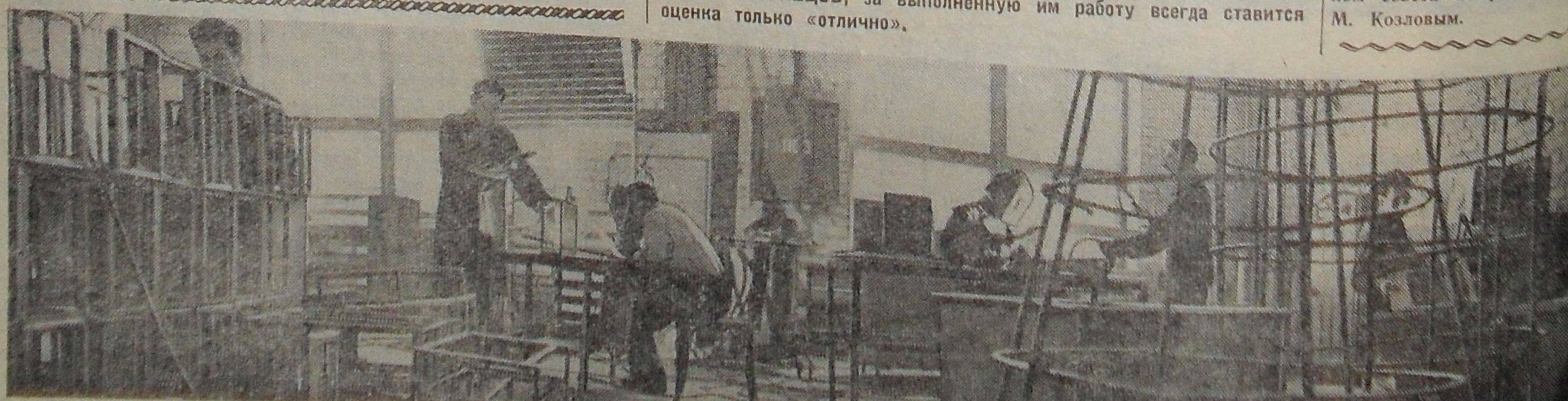
На фотоснимке сварочный участок ЦЭМа. Здесь радиоэлектронная стойка получает форму, становится каркасом. С каждым днем качество сварки блоков становится лучше и лучше. Приобретается навык и опыт.
