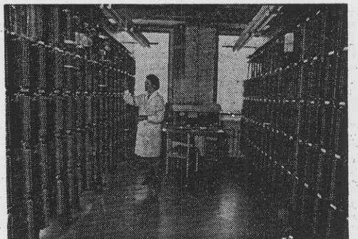
Щит переключений (на языке связистов — кросс). Здесь берет начало потоки телефонных разговоров, которые в час наибольшей нагрузки достигают цифры более тысячи. Электромонтер Е. В. Филиппова проводит измерение линии абонента.
