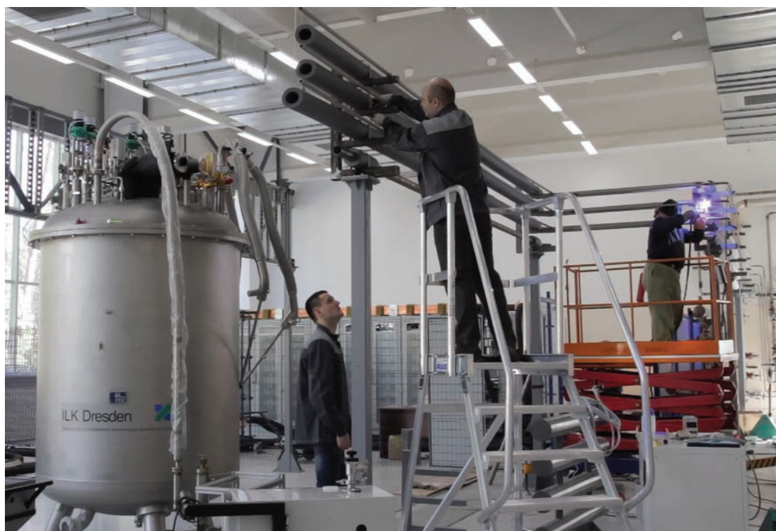
Лаборатория физики высоких энергий им. В. И. Векслера и А. М. Балдина, апрель. Сборка коммуникаций гелиевой системы стенда испытаний магнитных элементов ускорительного комплекса NICA
