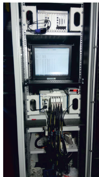
Рис. 3. Стойка с оборудованием
